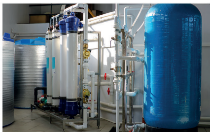
Sistemas de filtración de agua
