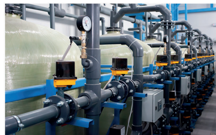
Tratamiento del agua
